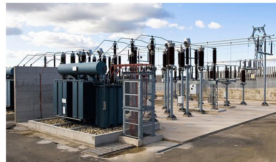
Figure 22 : Exemple d'une sous-station d'élévation de la tension (Source : Elo Energy, pour EDF, 2021)
